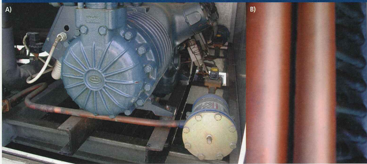
Particolare di un gruppo frigorifero: A) il collegamento tramite tubo in rame del compressore allo scambiatore; B) particolare dello scambiatore, a sua volta costituito da una fitta batteria di tubicini di rame e alette d'alluminio che aumentano la superficie di scambio termico.
